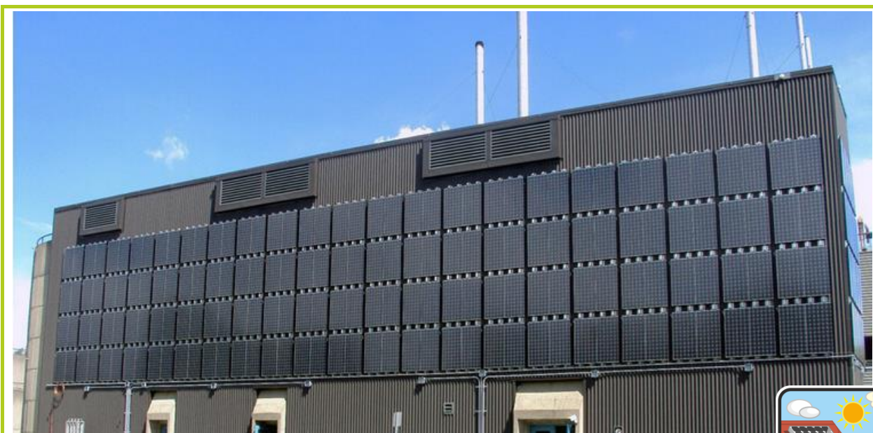
6.32 számú ábra: Hibrid, levegő előfűtő PV-t kollektor 68
