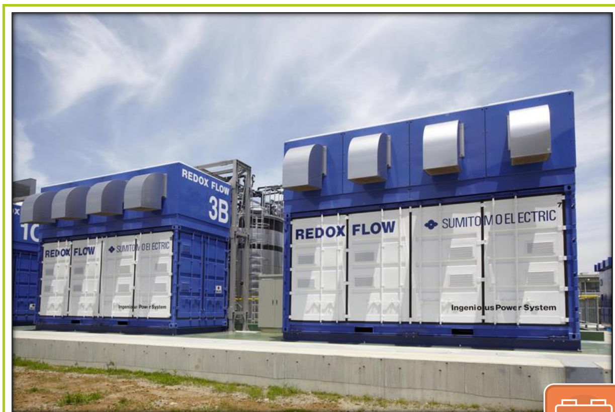
20.7 számú ábra: Vanádium-redox akkumulátor Japánban
